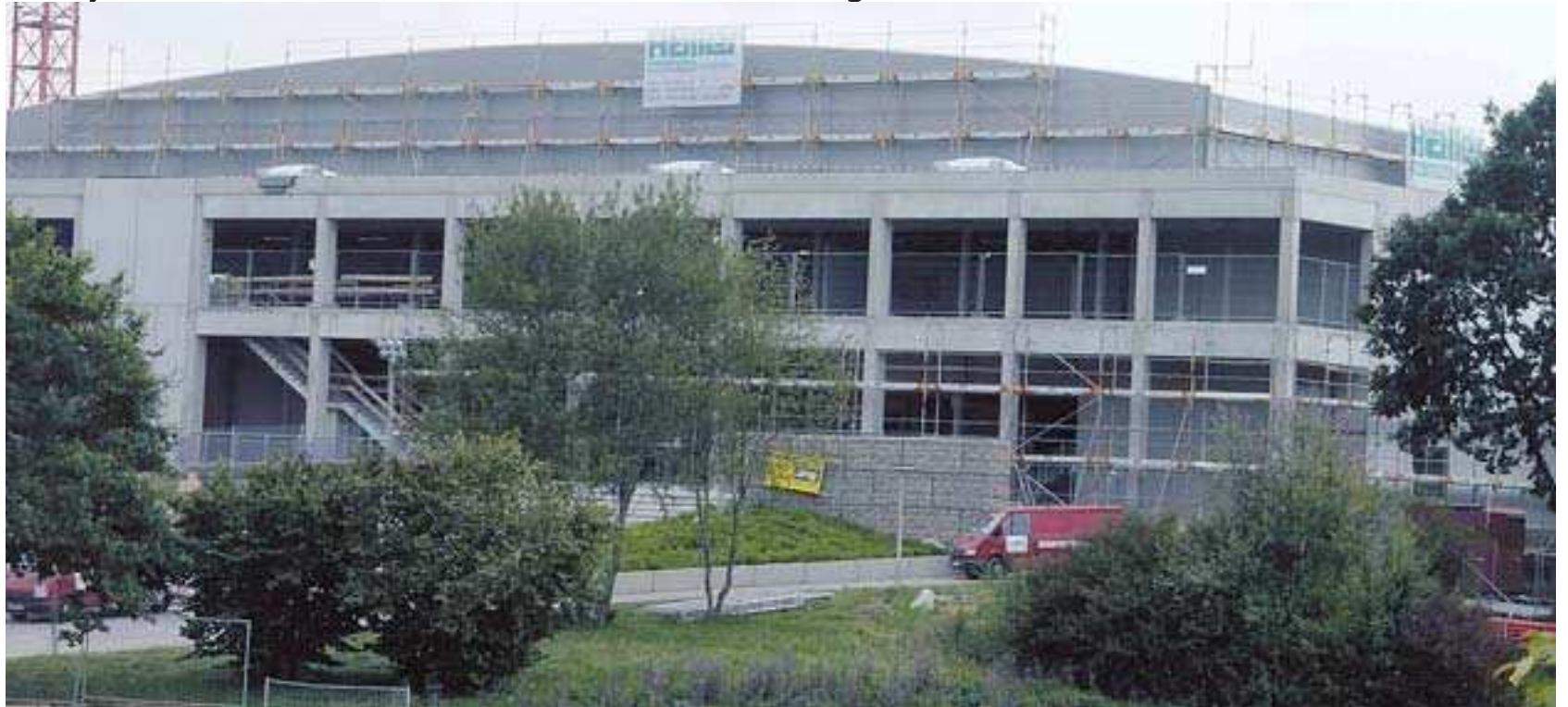
Mit neuem Dach hat das ehemalige Bauchenbergstadion, die jetzige Helios-Arena, auch den äußeren Charakter stark verändert.
