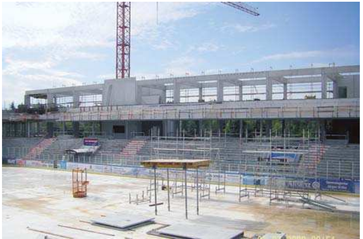
Im Juli war die Helios-Arena noch eine große Baustelle. Hier der Bau des Dachunterbaus mit den neuen Oberrängen.
